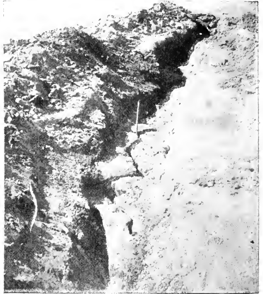
Excavación abierta á cinco pasos del chalet para descubrir la grieta
