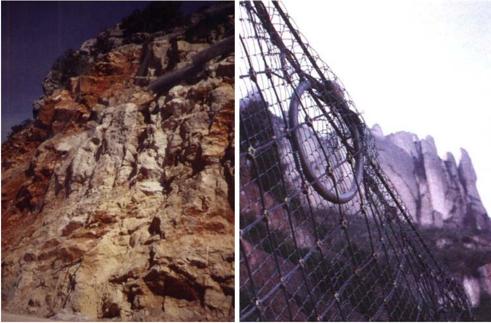
Fig. 17.6 – Talud desnudo y detalle de una malla de triple torsión
