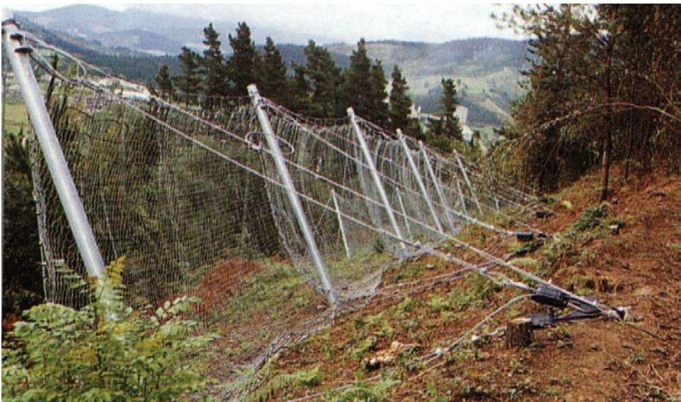
Fig. 17.7 – Barrera dinámica para la contención de fragmentos rocosos
