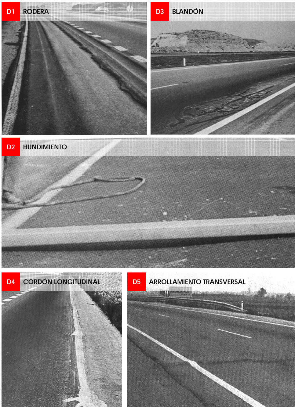
Fig. 25.1 – Deformaciones en firmes flexibles (I)
