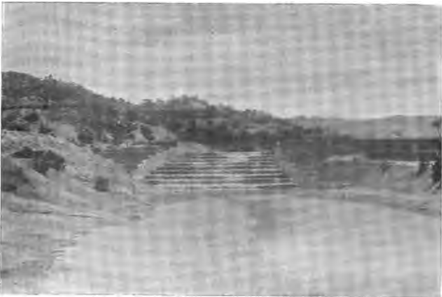
Abb. 88. Solide Stausperre mit Treppenabsturz bei Kusatsu (Biwaseegebiet).
