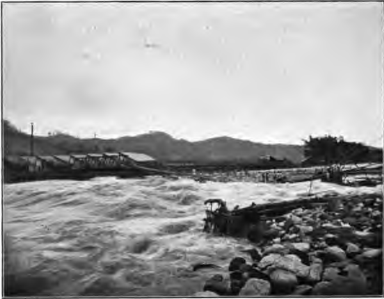
Abb. 78. Zerstörung einer eisernen Brücke durch die Hochfluten des Dayagawa bei Nikko im Juli 1906.
