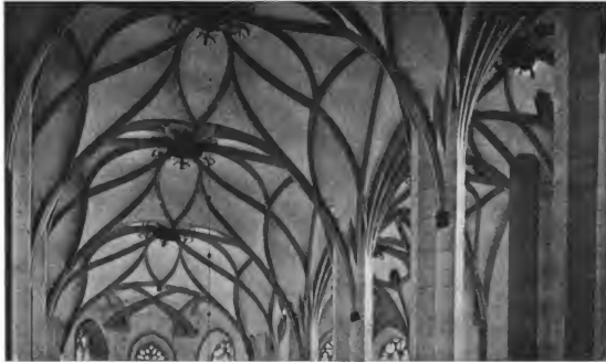
Abb. 40. Gewölbe der St. Annakirche in Annaberg vor der Restaurierung. (Nach Steche.)
