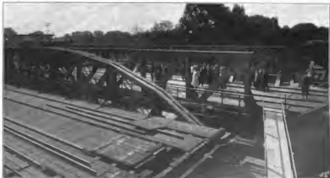
Abbildung 4. Auswechslung einer Flutöffnung. Alter Ueberbau bei Seite gesetzt. Die Auswechslung der eisernen Ueberbauten der Eisenbahnbrücke über die Elbe bei Magdeburg.
