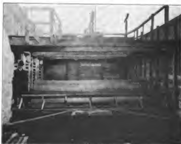
Abbildung 4. Aussteifung der Baugrube, Einstampfen des Widerlagers, Eisenbahrbücke in Eisenbeton im Zuge der Ringbahn bei Berlin.
