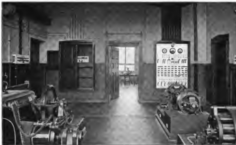
Abb. 6. Maschinenhalle mit Schalttafelwand und Blick ins Praktikum.
