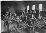
Fig. 3. Maschinenraum der Portland-Zementfabrik in Deutschland.
