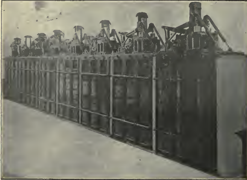
FIG. 25. 6,600 VOLT MAIN SWITCHES.
