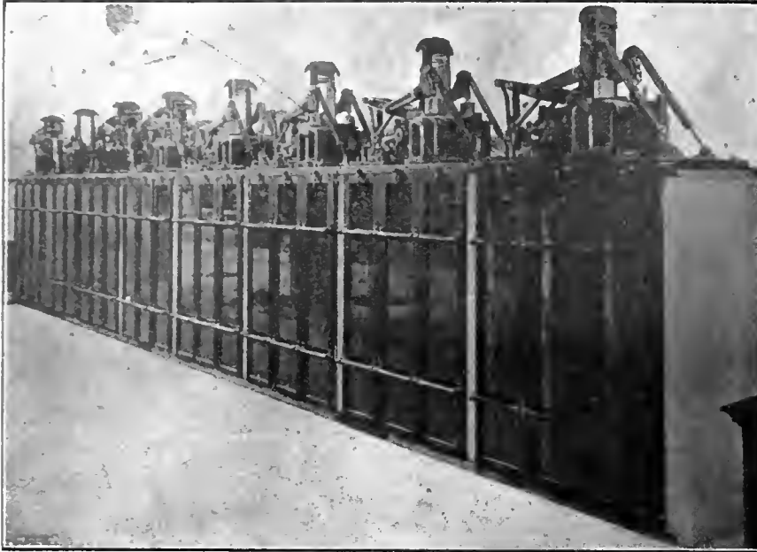
FIG. 25. 6,600 VOLT MAIN SWITCHES.
