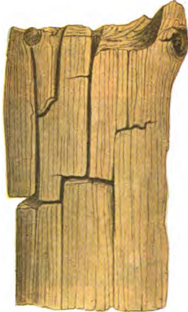
Fig. 22. Ein vom Hauschwamm völlig zerstörter Balken. \frac{1}{2} .
