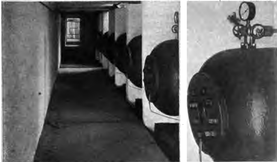
Abb. 40. Unterirdisches Gasochdrucklager Alhorn. Gang vor den durch Zwischenwände gegeneinander abgeschotteten Köpfen der Gastessel; man sieht die Armaturen der Kessel.
