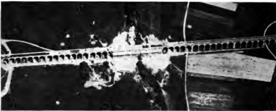
Abb. 262. Wiederherstellungsarbeiten am Viadukt Dammerkirch fast beendet. Durch das Gerüst hindurch die fertigen Bögen, auf dem Viadukt Baubuden und ein Arbeitszug erkennbar.
