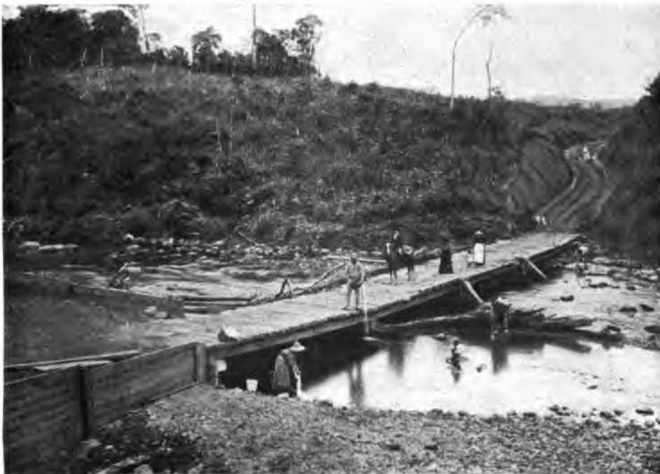
Abb. 30. Tiefliegende Brücke in der Joinviller Hansa.
