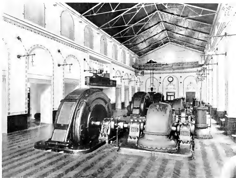
GROSSOTTO: INTERNO DELLA CENTRALE ELETTRICA « GIUSEPPE PONZO ».
