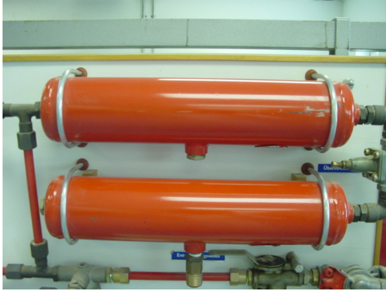
الشكل (5- 25) يبين خزانات الهواء
