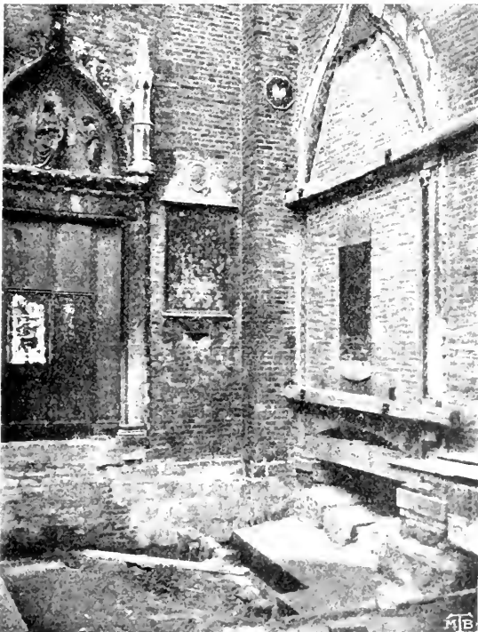
Capocroce settentrionale durante le opere di rinforzo alle fondazioni dei muri di perimetro.
