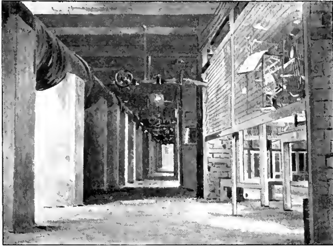
UNE DES GALERIES SOUTERRAINES SOUS LE BASSIN DU CHATEAU D'EAU A gauche, la conduite des eaux ; à droite, les appareils d'éclairage des jets d'eau.
