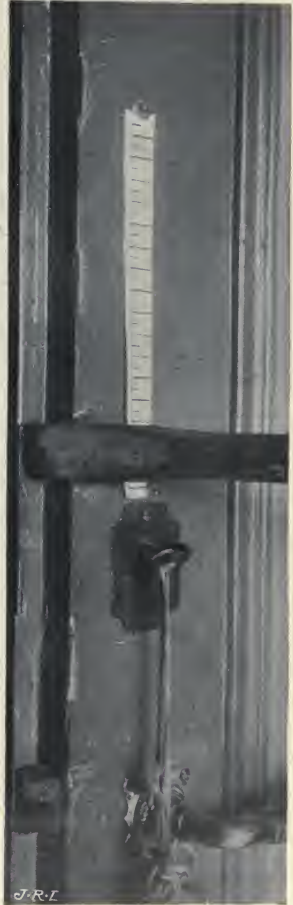
FIG. 29. — Pesées sur une porte fracturée avec l'outil qui a servi à l'effraction.
