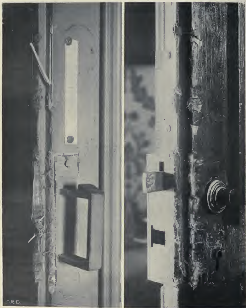
FIG. 28. — Le montant et le battant d'une porte fracturé par un cambrioleur novice, (attaque de la porte près de la serrure).
