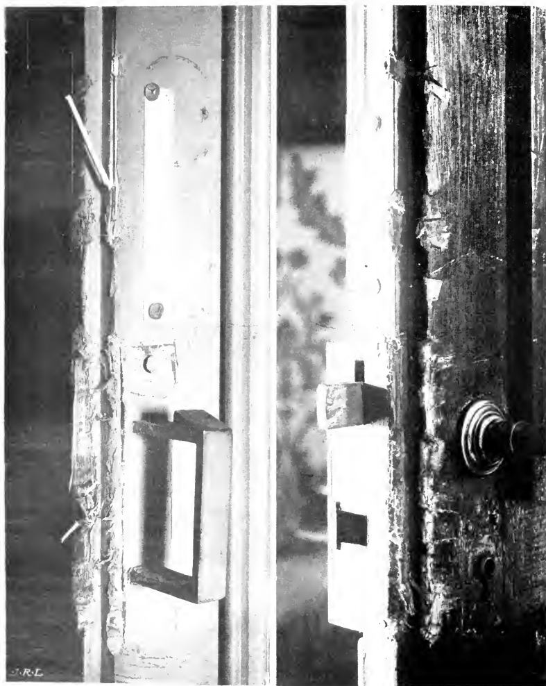
FIG. 28. — Le montant et le battant d'une porte fracturé par un cambrioleur novice, (attaque de la porte près de la serrure).
