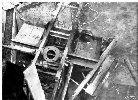
FIG. 67. — Photographie sur les lieux (accident) : la grue vue d'en haut (photographie avec un pied à renversement).
