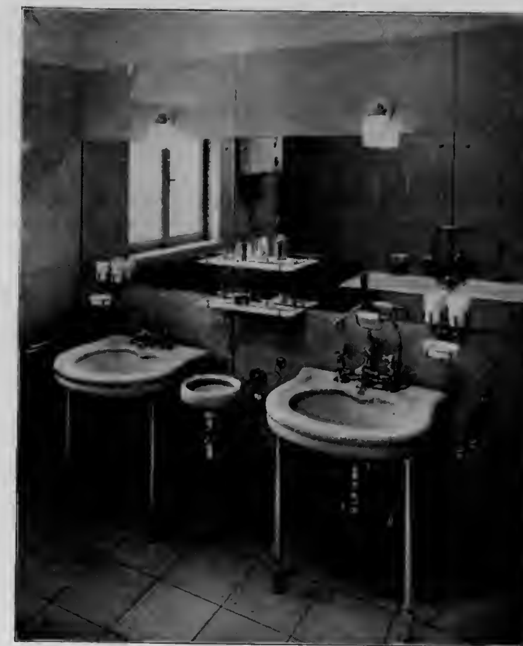
Koupelna v domě T. • Projektant: arch. J. Haas, Brno. • Sanitní zařízení provedla firma KARL HELLER , instalace sanitního zařízení Brno, Hybešova 51, tel. 11.637. • (Výrobky si besplatně u nezávislého nabídky).
