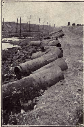
Replaced Wood Pipe Along D. L. & W. R. R., Jersey City, N. J.
