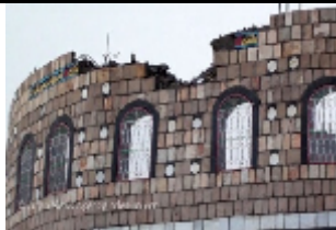
آثار القصف العشوائي على منازل المواطنين في مدينة لودر بمحافظة أبين بتاريخ 20.08.2010
