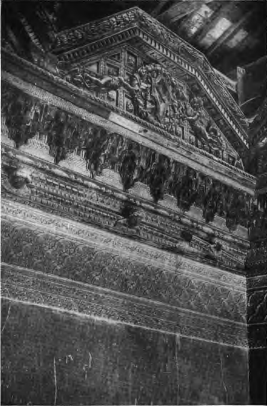
DILAPIDATED ARTESONADO OVER THE STAIRWAY OF THE PALACIO DE PEÑARANDA DE DUERO.
