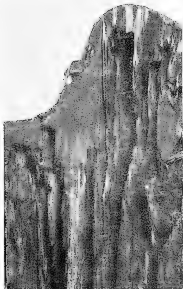
Fig. 74. — Poutre d'Épicéa ravagée par la Formica herculeana L. (la périphérie est restée indemne), 1/2 gr. nat. (orig.).
