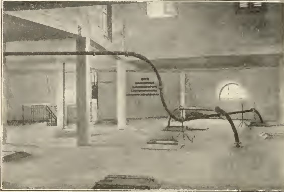
Fig. 30. Verteilungsröhren oben im Silospeicher. Mittelst des längeren Rohres wird das vom Reinigungsspeicher herübergeblasene Korn in die am Boden sichtbaren Öffnungen der verschiedenen Silozellen geleitet, während das von unten kommende kürzere Rohr zur Umlagerung von einer Zelle in die andere dient.
