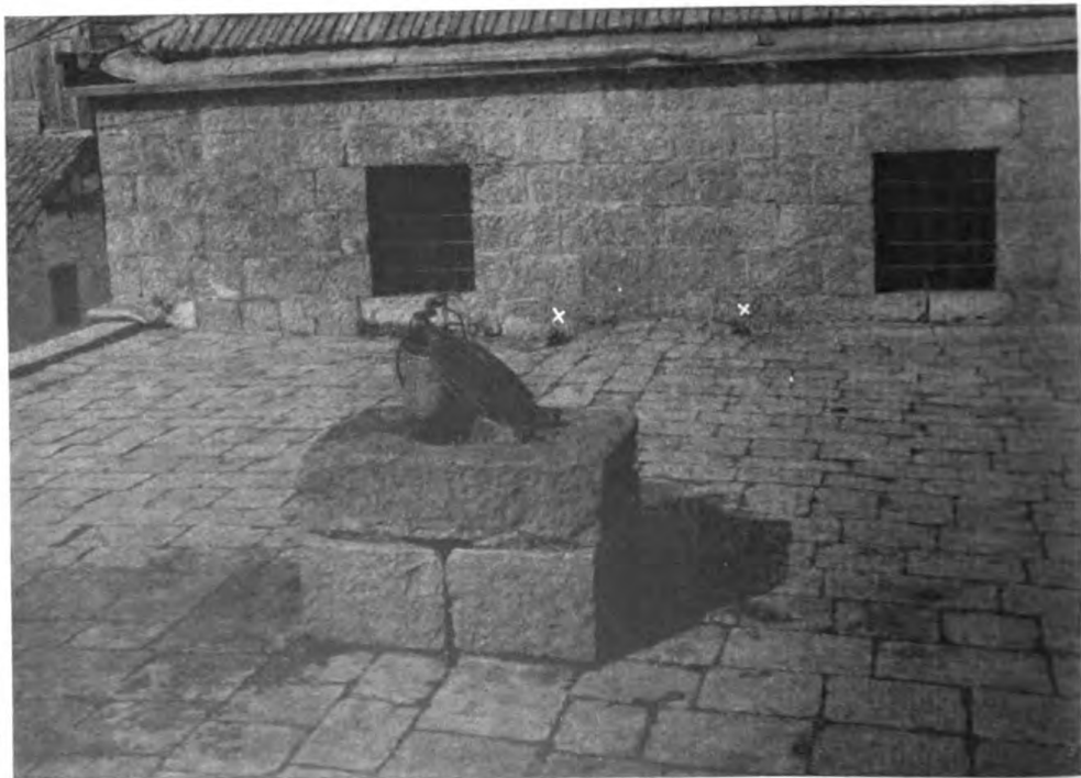
Fig. 17. Große Zisterne Nahlath Zion. Aufbau undicht; an der Hauswand zwei kleine Löcher in der Zisterne. (x)
