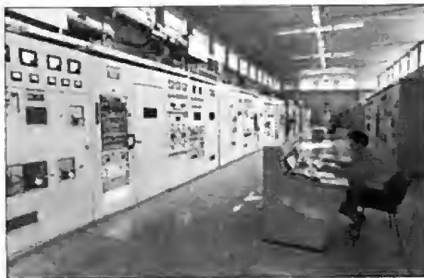
Радиоцентр Поповки, Ленинградская обл. Зал КВ передатчиков, откуда в 1971-1988 гг. вели радиоподавление польской службы Радио Свободная Европа/Радио Свобода (RFE/RL) с позывным «1Г». Передатчики мощностью 200 кВт, пары – до 400/800 кВт.
