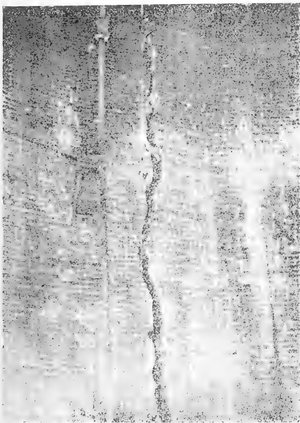
Fig. 12.—Grieta en el pozo de desagüe del estanque de San Andres
