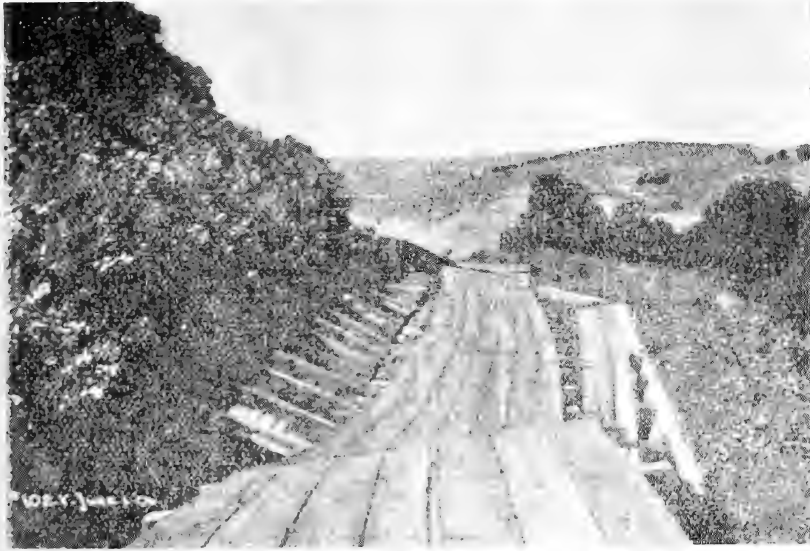
Fig. 16.—Daños a las armazones de las cañerías de San Andres
