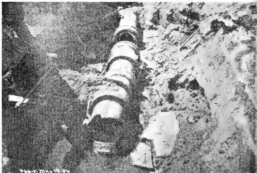
Fig. 27.—Ruptura de cañerías (Esquina de las calles séptima i de Howard)
