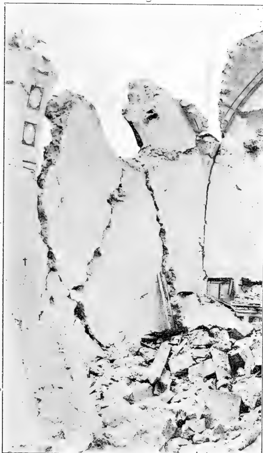
Fotografía número 2.—Muro cuarteado de la iglesia de Cosautlán, Ver. (Orientado de NE. a SW.)
