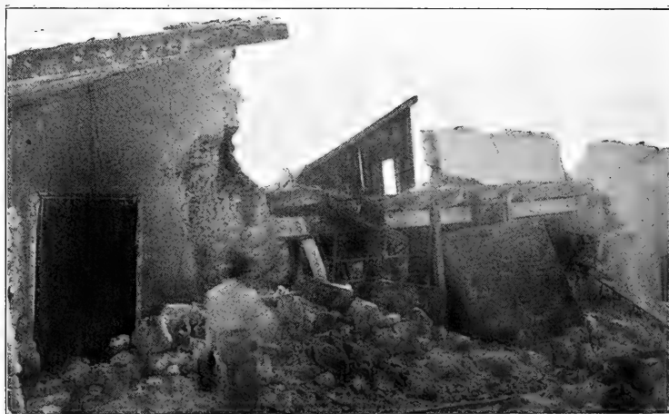
Fotografía número 4.—Casas destruídas en la calle de Leona Vicario, Jalapa, Ver.
