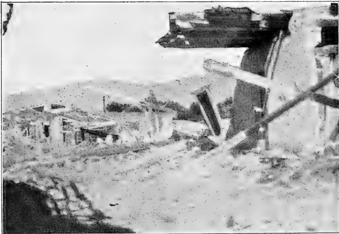
Fotografía número 2.—Cosautlán, Ver. Destrucciones en el costado norte del templo.
