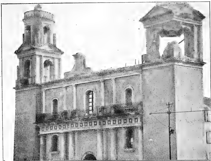
Fotografía número 1.—Torre destruída del templo de Teocelo, Ver.
