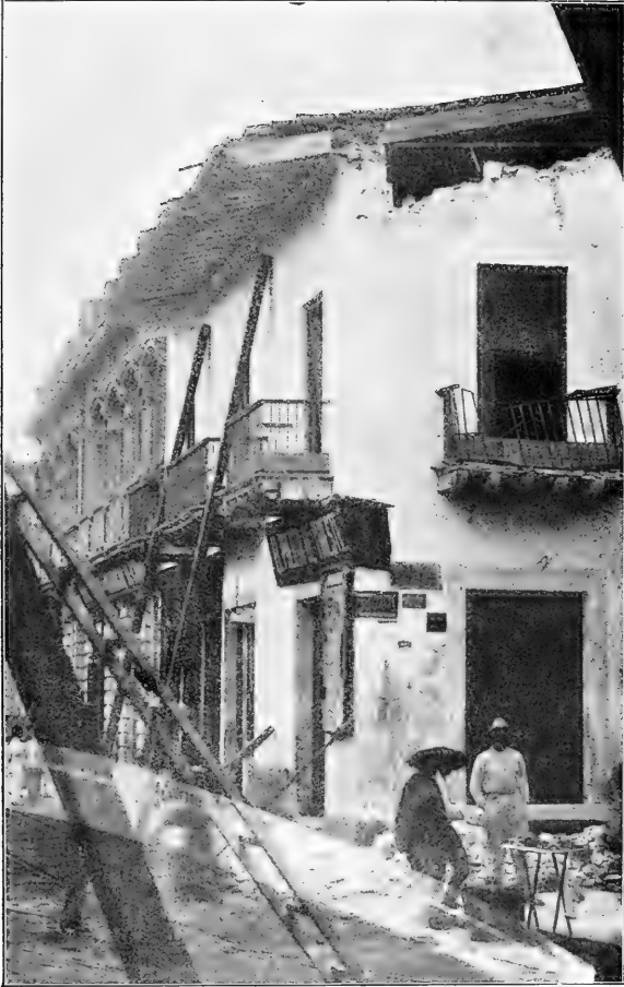
Fotografía número 1.—Conjunto de las destrucciones en la esquina de la 11.ª calle de Zamora y de la calle de Alba, Jalapa, Ver.
