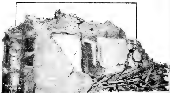
Fig. 5. — Cattiva costruzione (Linera).
