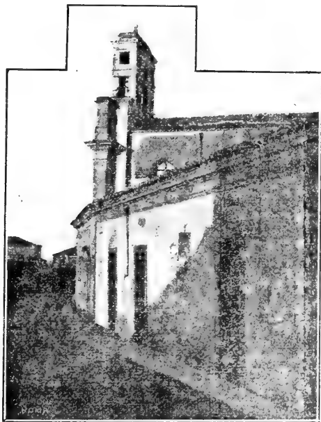
Fig. 24. — Chiesa di Bongiardo, di fianco. Meglio che sulla fig. 8 si vedono le lesioni dei pilastri del campanile.
