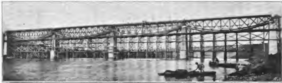
Abb. 155. Dolesterbrücke bei Zaleszczyki. [Linie Lužan-Zaleszczyki.] [Nach einer photographischen Aufnahme von F. Jaworski in Lemberg.]
