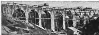
Abb. 129. Viaduct beim Nordwestbahnhofe Iglau im Bau. [K. k. Staatsbahn Iglau-Neuhaus-Wessely.] [Nach einer photographischen Aufnahme von J. Haupt, Iglau.]
