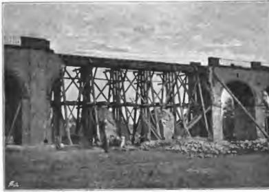
Abb. 20. Eisenbahn-Viaduct der Nordbahn bei Jessernik nach der am 14. Juli 1866 erfolgten Sprengung, mit dem von den preussischen Truppen hergestellten Provisorium. [Nach einer Photographie aus dem histor. Museum der k. k. Staatsbahnen.]
