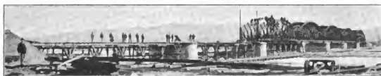
Abb. 153 a. Isonzo-Brücke im Bau. [Monfalcone-Cervignano.] [Nach einer photographischen Aufnahme von Corte Sebastianutti-Benque, Triest.]
