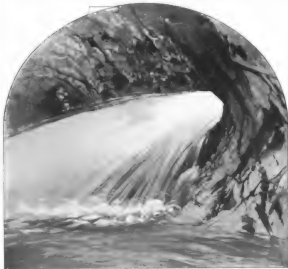
Wassereintrich im südlichen Tunnelstollen.
