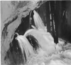
Wassereintrich im südlichen Tunnelstollen.
