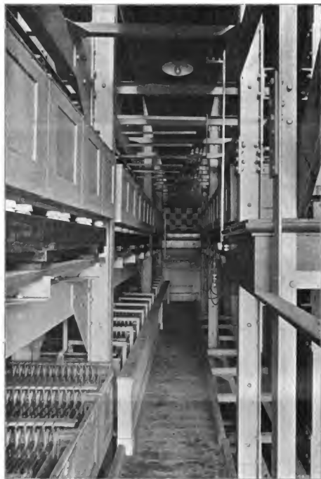
Unterstation A Akkumulatorenraum. Fig. 6.
