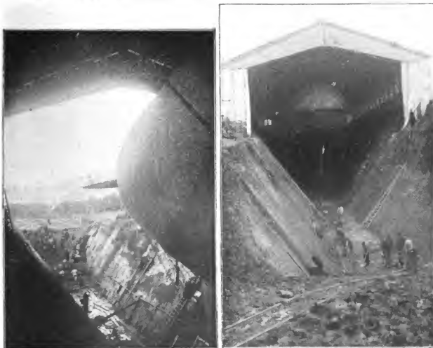
La tranchée qu'il a fallu creuser pour permettre au ballon Lebaudy d'entrer dans le hangar à Toul.
