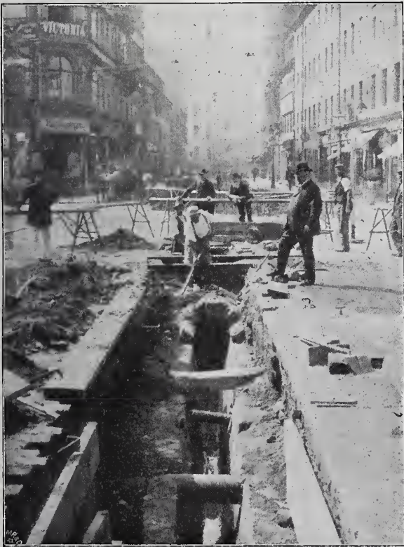
Abbildg. 3. Alter Kanal. Von Leitungen anderer Verwaltungen durchkreuzt.
