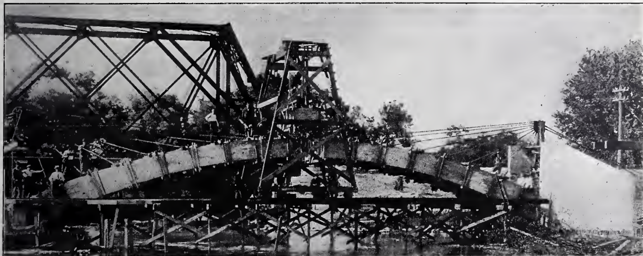
Abbildung 5. Montage der Eisenbeton-Bogenlehre. (Der links erscheinende Eisen-Fachwerkträger gehört zu einer anderen Brücke.)
