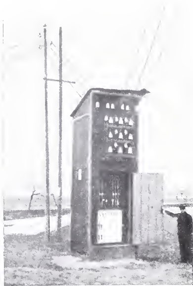
8. — TRASFORMATORE FISSO IN UN'EDICOLA DI LAMIERA IN MEZZO AI CAMPI.
