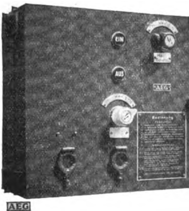
Abb. 3. Schalttafel zum Fernantrieb.
