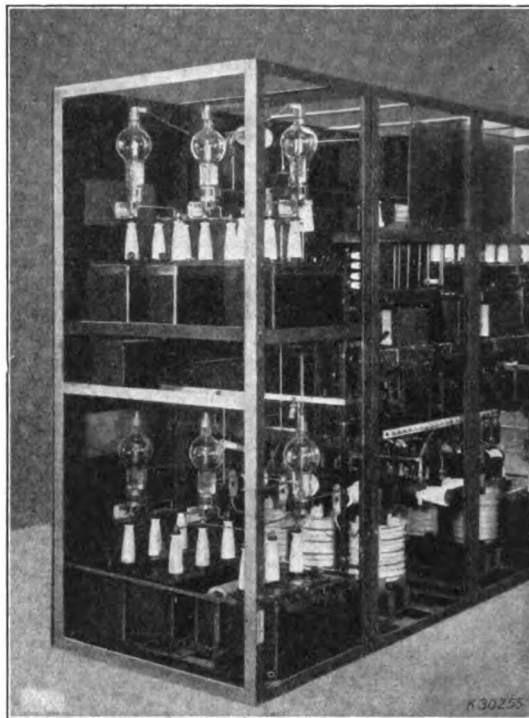
Abb. 4. Rückansicht des Gleichrichtergestells (Röhrenteil).
