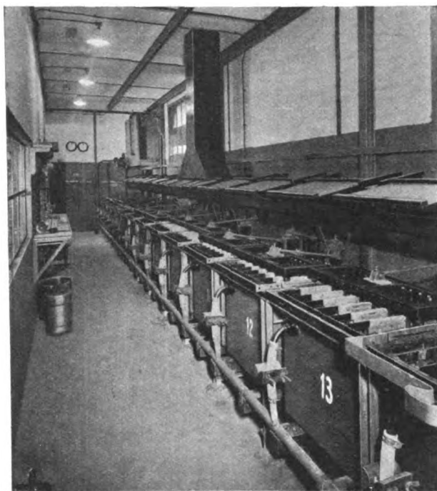
Bild 3. Entkupferungsanlage mit 13 Entkupferungsbädern und einem Mutterblechbad.
