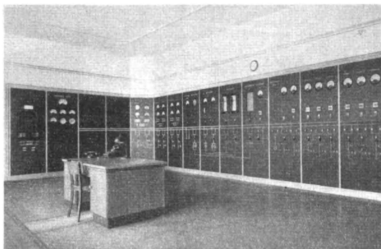
Bild 1. Schaltwarte mit Blindschaltbild für ein Umspannwerk.
