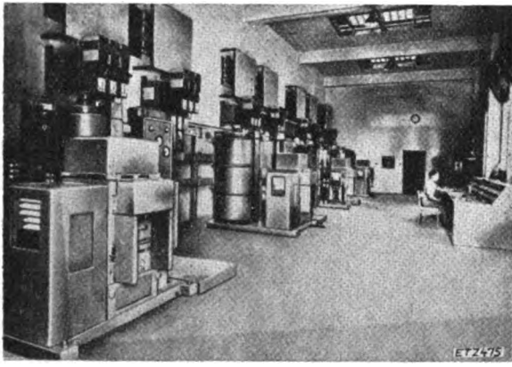
Bild 8. Kontaktgleichrichteranlage der SSW, 32 000 A, 400 V, für Chlor-Elektrolyse.
