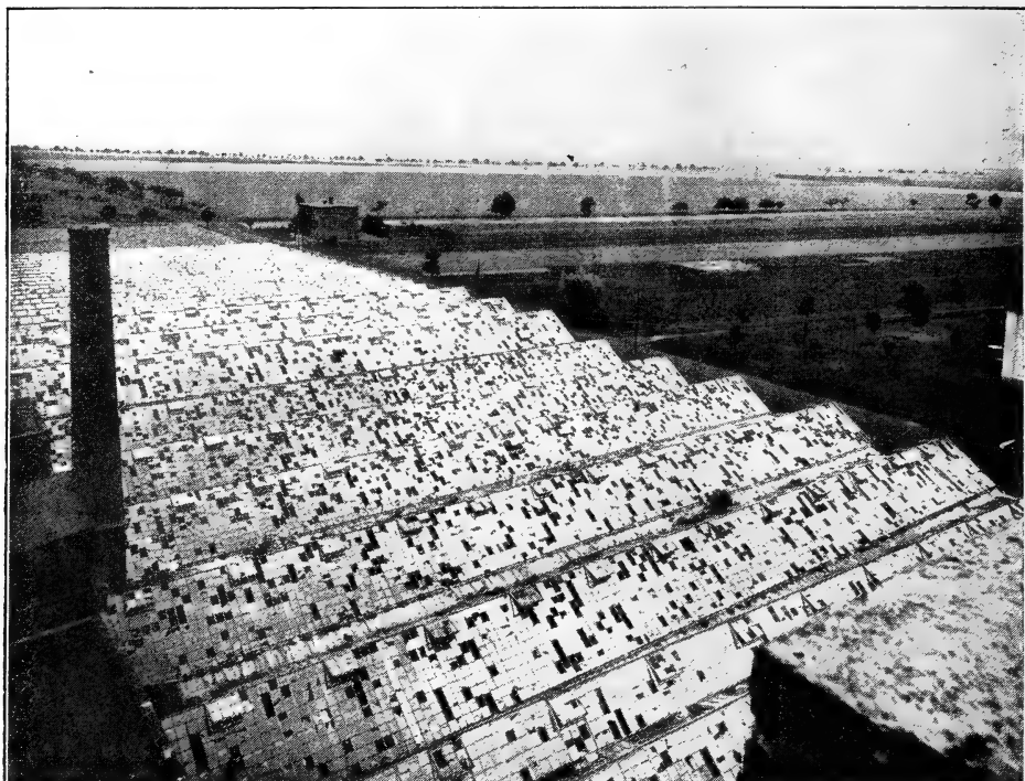
Abb. 15. Durch Hagelschlag beschädigte Gewächshäuser.
