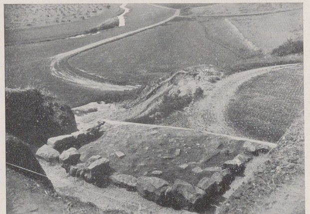
ABB. 11. TURM am Rande der Kiesgrube. Ein Teil des Turms ist schon weggestürzt. Der Turm ist durch eine Eisenbetonplatte unterfangen
