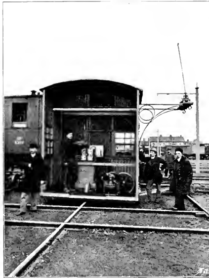
Abb. 382. Motorhäuschen der elektrisch betriebenen Schiebebühne.
