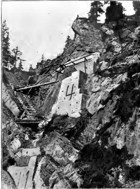
Abb. 156. Steinschlag-Schutzbau auf der Arlbergbahn im Schnänn (Felskopf nach der Verbauung). [Nach photographischen Aufnahmen im Besitze der k. k. Staatsbahn-Direction Innsbruck.]
