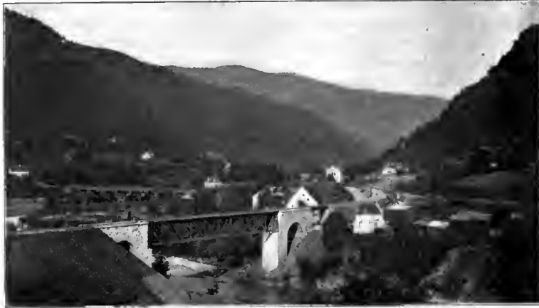
Abb. 202. Miesbrücke bei Unter-Drauburg. [Unter-Drauburg-Wolfsberg.] [Nach einer photographischen Aufnahme von Alois Beer in Klagenfurt.]
