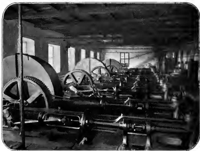
Abb. 138. Pumpenhaus in Langen.
