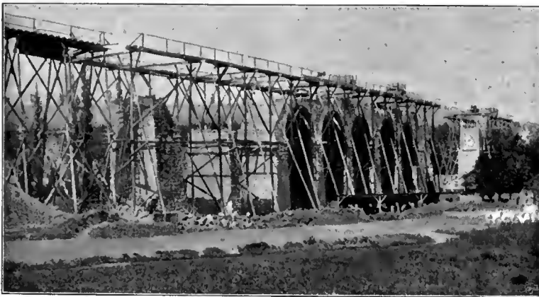
Abb. 160. Bau des Viaductes und der Brücke über den Igelfluss in Iglau. [Böhmisch-Mährische Transversalbahn]. Nach einer Photographie von Johann Haupt in Iglau.
