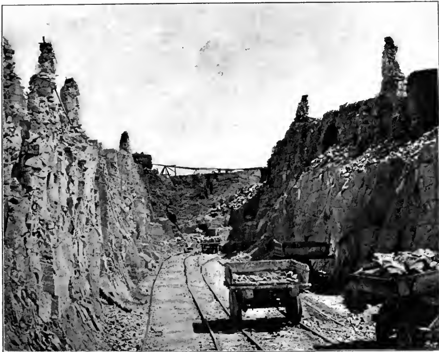
Abb. 35. Meteniower Einschnitt während des Baues [Carl Ludwig-Bahn, 1869]. [Nach photographischen Aufnahmen von Jos. Eder in Lemberg.]
