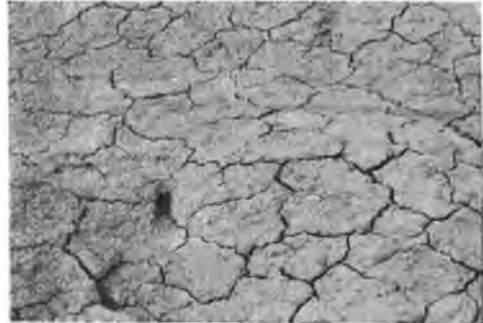
Fig. 18. Trockenrisse in Ton.
