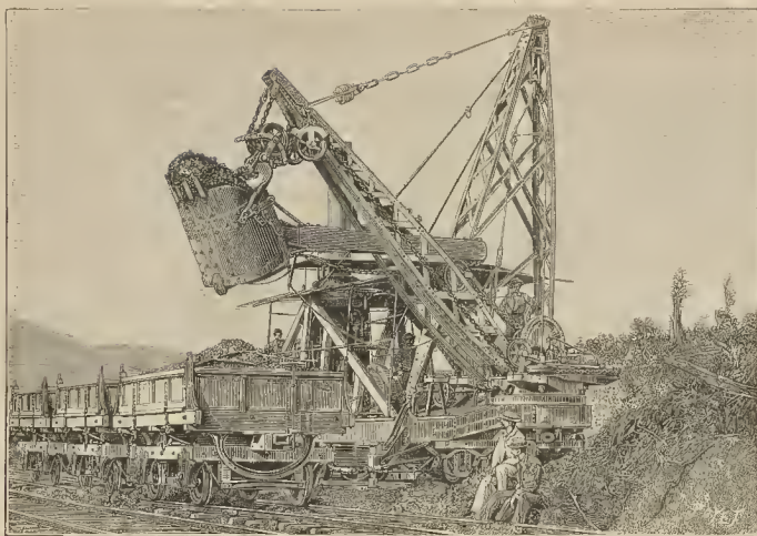
Trabajos de perforación del istmo de Panamá. — El excavador Osgood en la zanja grande La Culebra
