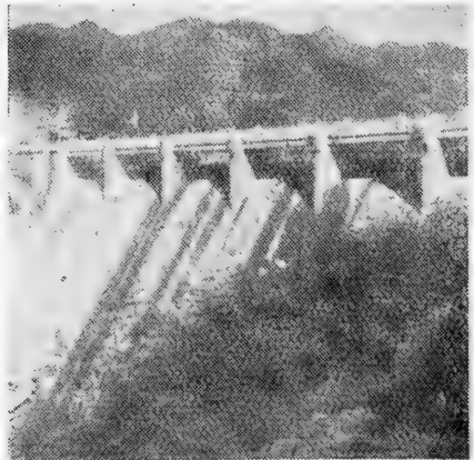
衡山縣南岳水庫的圬工滾水壩，高26.6公尺，灌田5,000畝，發電200瓩，圖為滾水壩下游面全景
