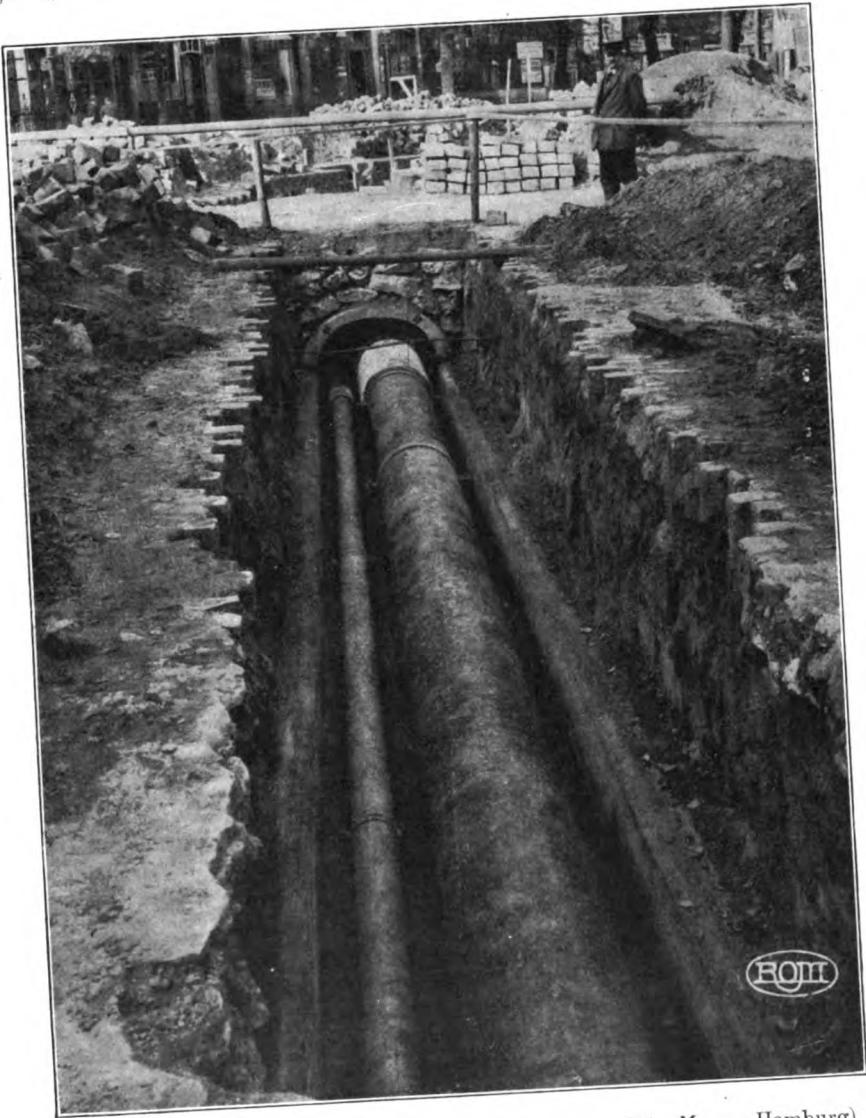
Fig. 110. Rohrleitungen eines Fernheizwerkes (Rud. Otto Meyer, Hamburg).
