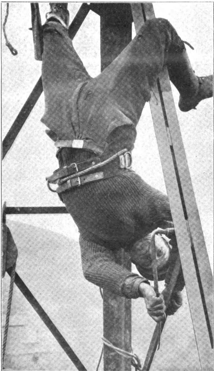
Metallarbeiter bei der Montierung des 100 m hohen Mastes des neuen Rundfunksenders in Langensfeld i. Rhld. Phot. Rosenkranz
