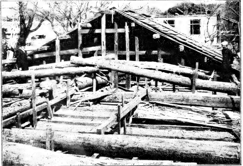
第六師團步兵第三聯隊(本熊)營倉小屋白蟻被害の状況
