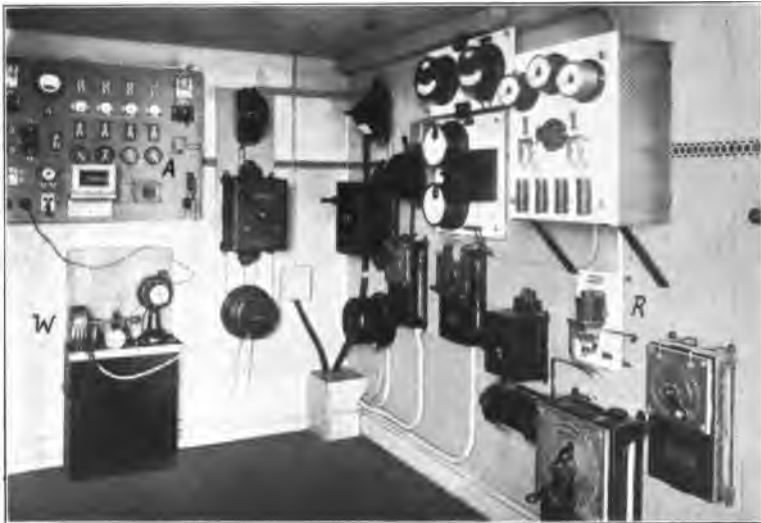
Abb. 145. Schaltraum der Zeppelin-Telefunkenstation Frankfurt a. M. mit Sendeautomaten.
