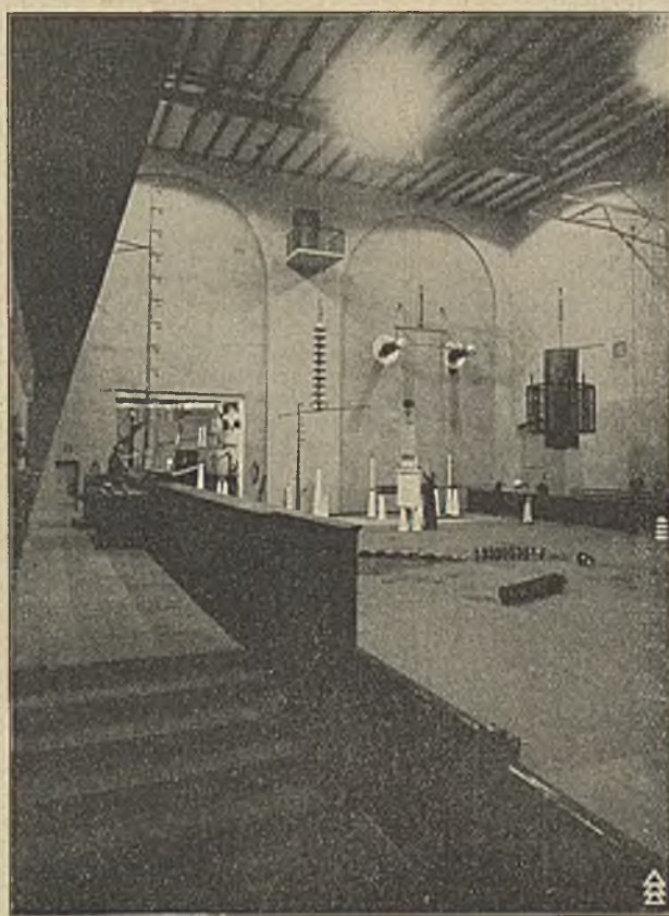
Abb. 22. Neues Höchstspannungs-Versuchsfeld der Hermsdorf-Schomburg-Isolatoren G. m. b. H. Im Hintergrund rechts der Tesla-Transformator für maximal 1,4 Mill. V.
